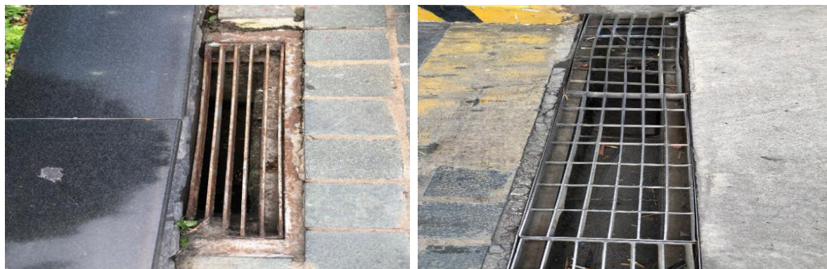
Hình 3.2. Hệ thống thu gom, thoát nước mưa tại cơ sở
